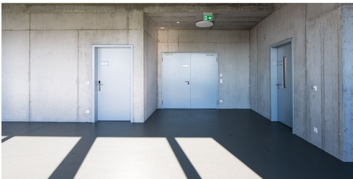
Stahl-Feuerschutztüren STU-1 Ei2 30 C und Stahl-Feuerschutztür STU-2 Ei2 30 C
